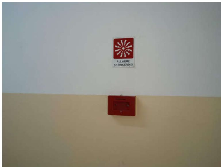
Impianto di allarme in v. Otranto
